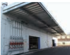
危険物倉庫・泡消火設備
